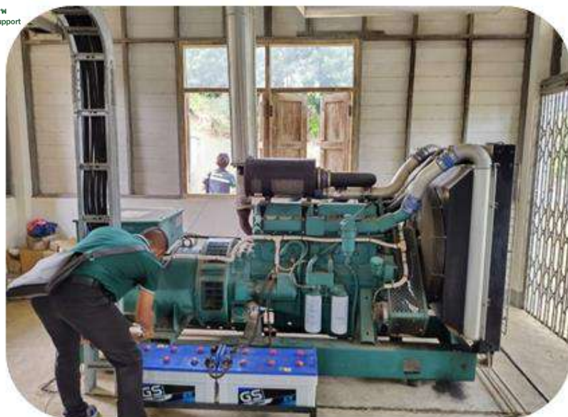
เครื่องกำเนิดไฟฟ้า(พิกัด๒๕๐KVA.) / น้ำมันเชื้อเพลิง สำรอง ๖๐๐ลิตร
