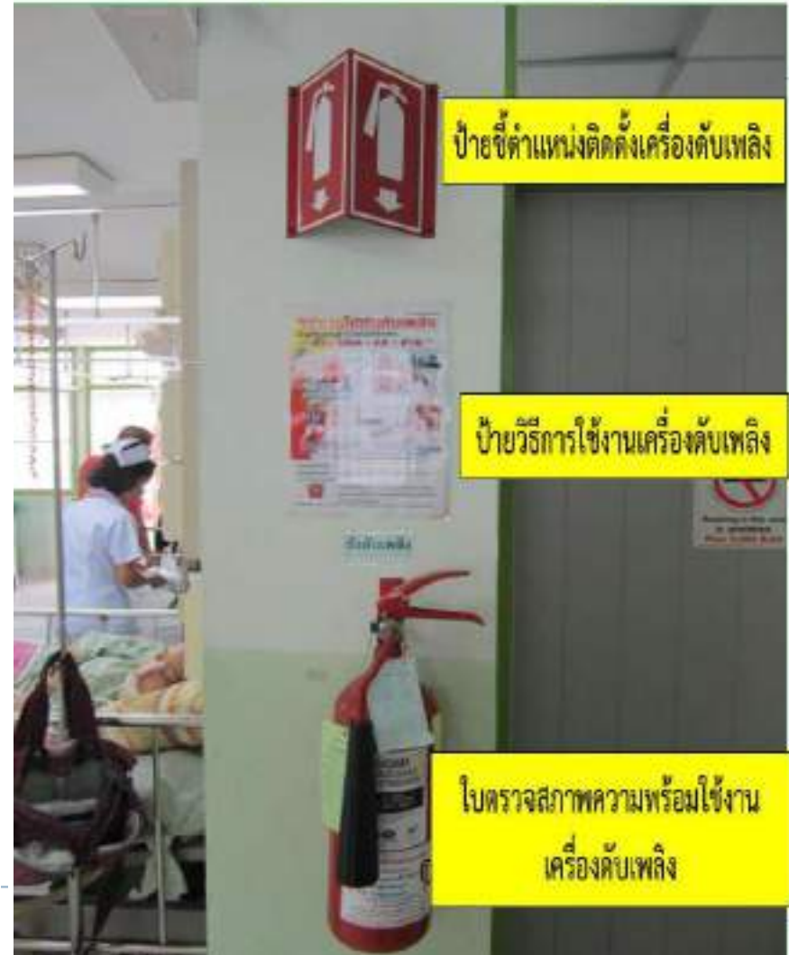
ตัวอย่างจุดติดตั้งถังดับเพลิง
