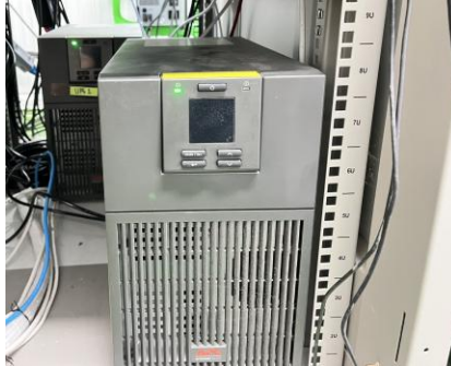
เครื่องสำรองไฟ UPS ขนาด ๒ kVA
