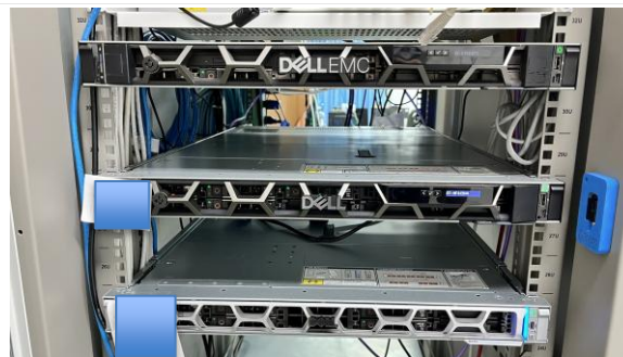
เครื่องคอมพิวเตอร์แม่ข่ายภายในห้อง Data Center
