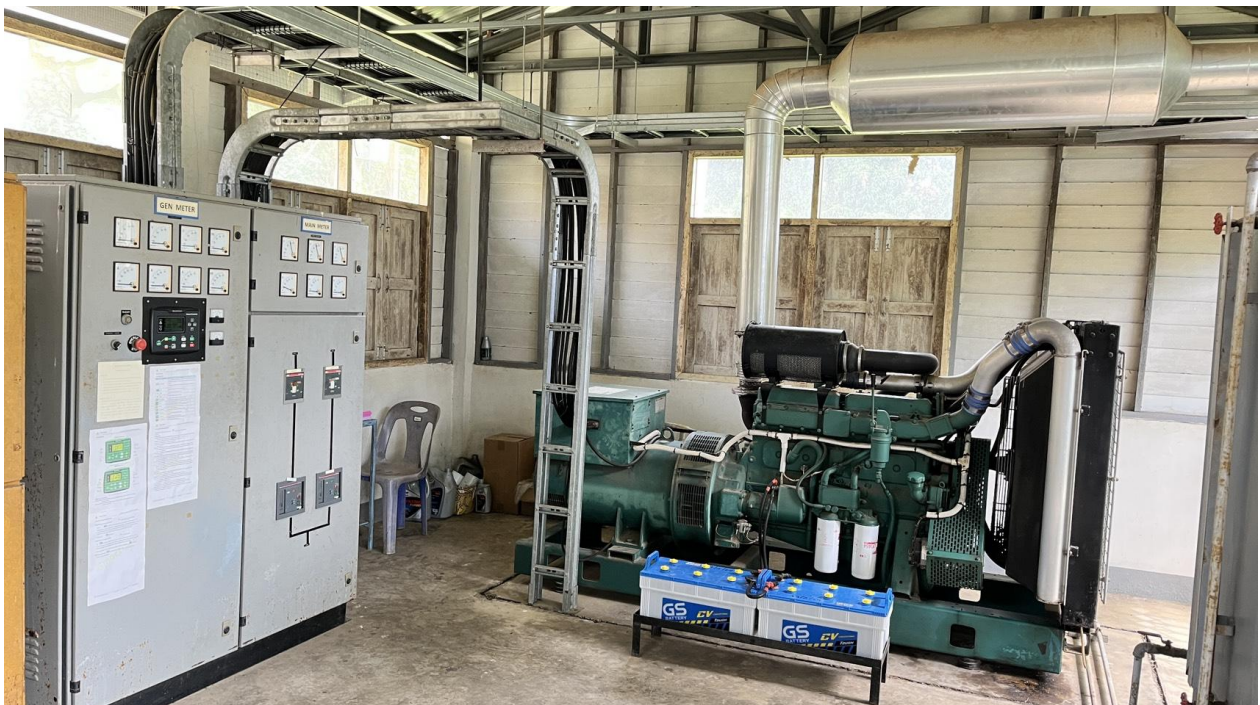
เครื่องกำเนิดไฟฟ้าฉุกเฉินของโรงพยาบาลสองแคว
