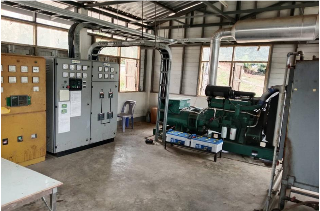
ระบบไฟฟ้าสำรองฉุกเฉินจากเครื่องกำเนิดไฟฟ้า
