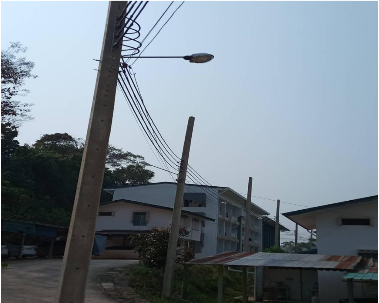
ระบบไฟฟ้าแสงสว่างภายนอกอาคาร
