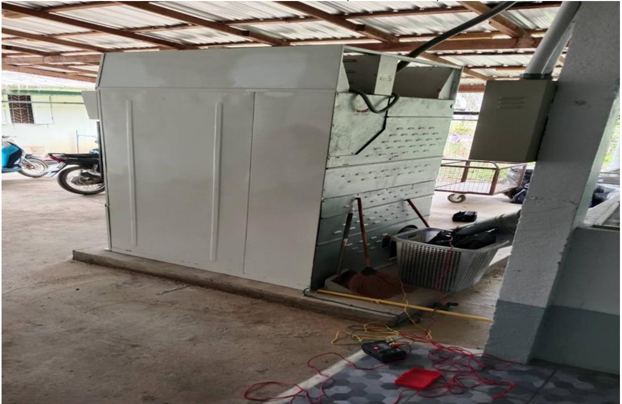
ระบบการต่อลงดินของเครื่องมืออุปกรณ์ไฟฟ้า(กลุ่ม๒)
