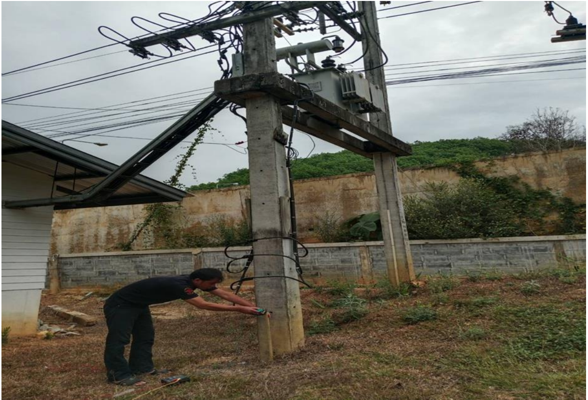
บริเวณที่ติดตั้งหม้อแปลงไฟฟ้าแบบนั่งร้าน
