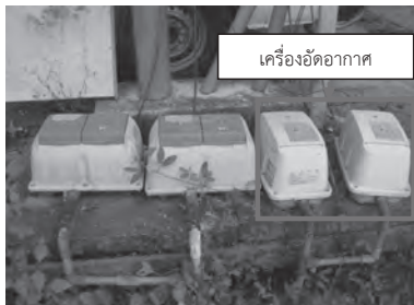
เครื่องอัดอากาศ (Air compressor)
