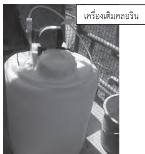
ระบบเติมคลอรีน
